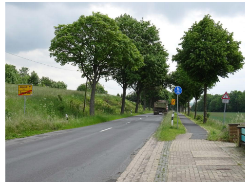
SI: Segeste – Bahnhofstraße Geh-/Radweg mit Schäden
