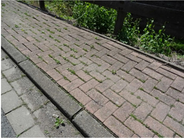
LA: Graste – Lamspringer Straße mangelhafte Belagsqualität
