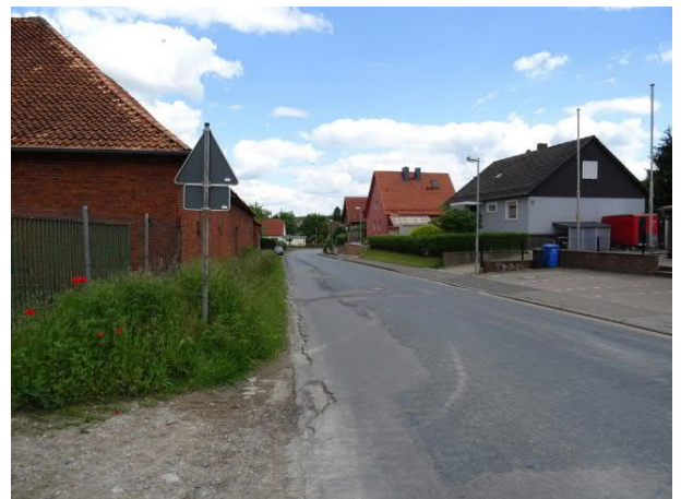
EL: Esbeck – Auf der Böhne mangelhafte Belagsqualität am Fahrbahnrand
