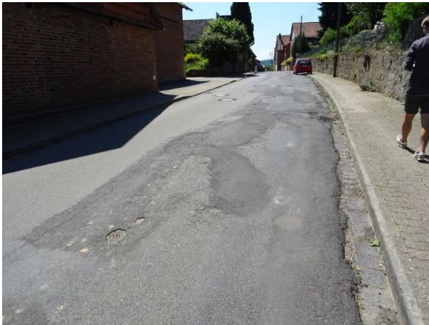
FR: Eyershausen – Hauptstraße mangelhafte Belagsqualität
