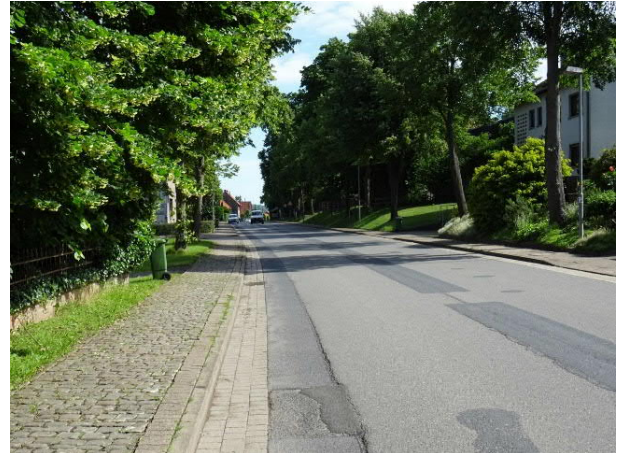
LA: Sehlem – Sehlemer Hauptstraße unebene Pflasteroberflächen
